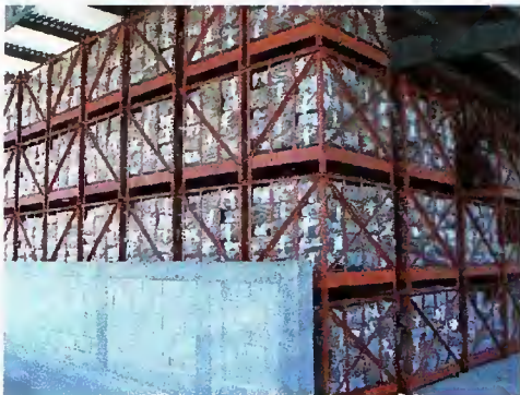
Racks para almacenamiento de Granulado
